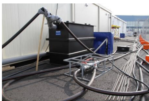
仮設給排水システムの事例
