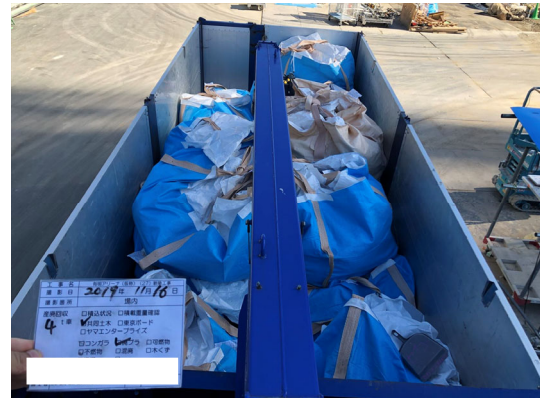
写真 8.2-4 再資源化施設搬入
