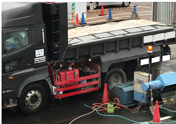
写真 8.1-3 タイヤ洗浄設備
