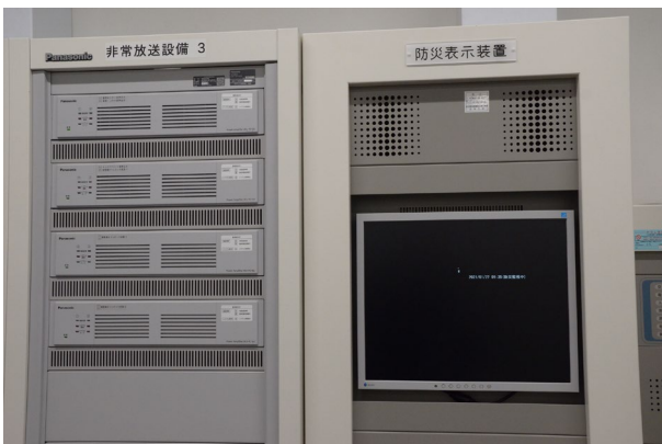
非常放送設備・防災表示装置
