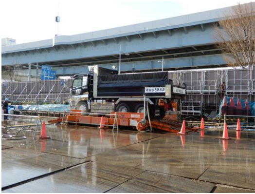
写真 8.5.1-1 タイヤ洗浄設備
